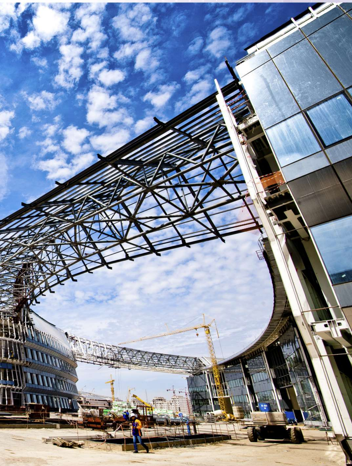
Павильон «Энергия будущего», соединенный с международными павильонами декоративными мостами
