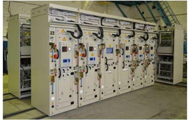
Низковольтные распределительные устройства
