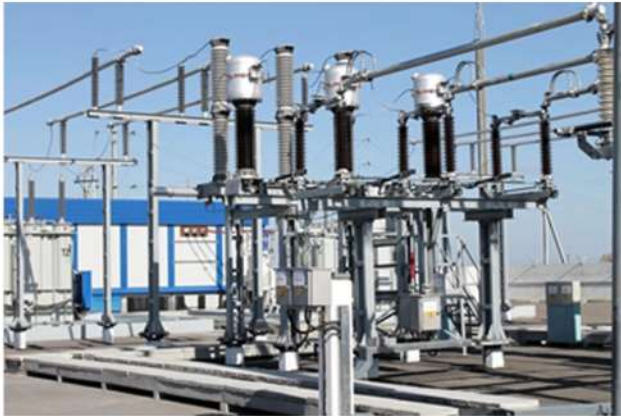
Открытые распределительные устройства
